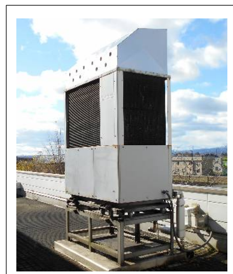
空調設備の室外機（現設備）
