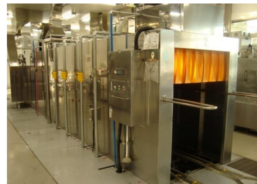
【コンテナ洗浄機】
