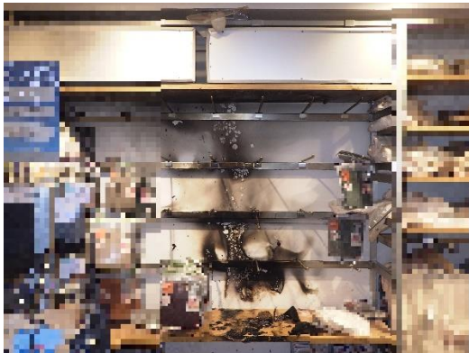
写真9 店舗内の焼損状況
