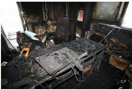
写真7 事務室の焼損状況
